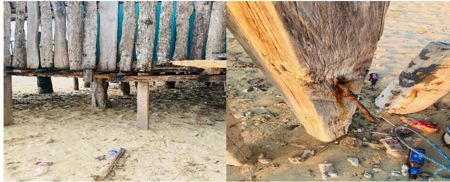
Gambar 1. Kondisi Pondasi Tiang Kayu yang Sudah Mengalami Penggerusan Pasir dan Pelapukan (Sumber: Dokumentasi pribadi 2026)
